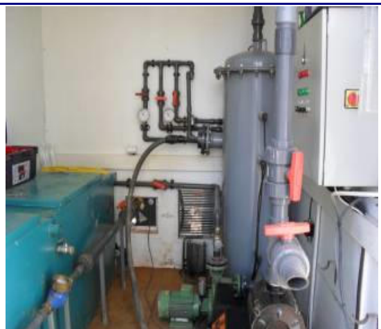
Equipo de tratamiento Alto Vacío
