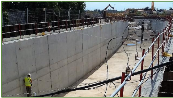
Foto 3. Alineación de pozos profundos.
