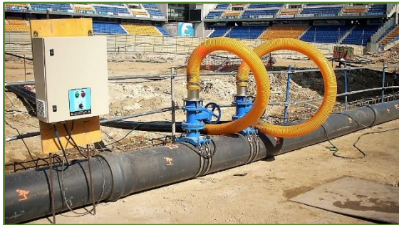
Foto 4. Cuadro de control.
