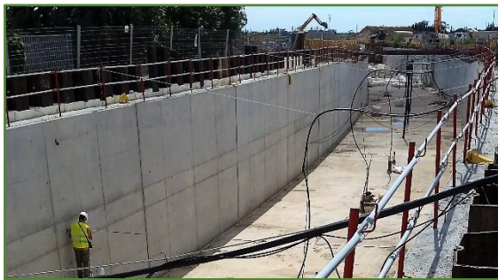
Foto 3. Alineación de pozos profundos.
